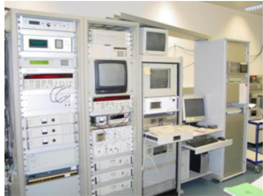
Unidade de receção, monitorização, transferência e emissão de sinais
