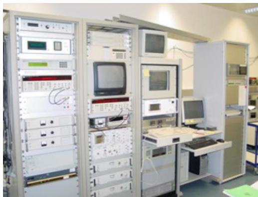
Unidade de receção, monitorização, transferência e emissão de sinais
