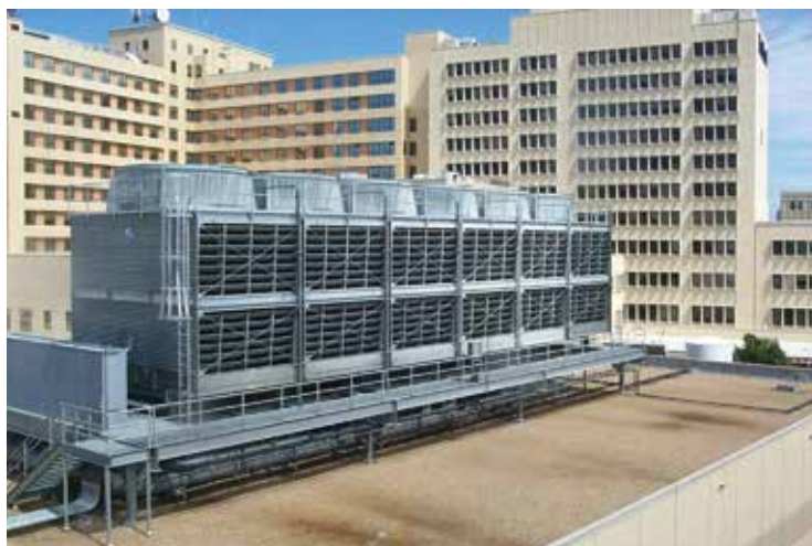
Figura 4: Condensador evaporativo localizado no exterior das instalações
